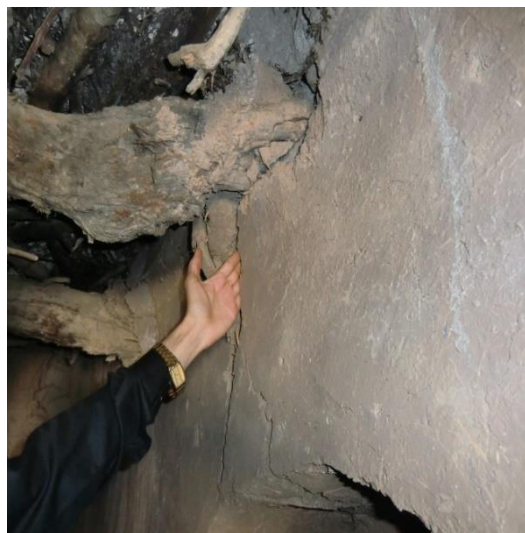
شکل ۶. تصویری از شکاف ایجاد شده در دیوار منازل روستای هاوانان
