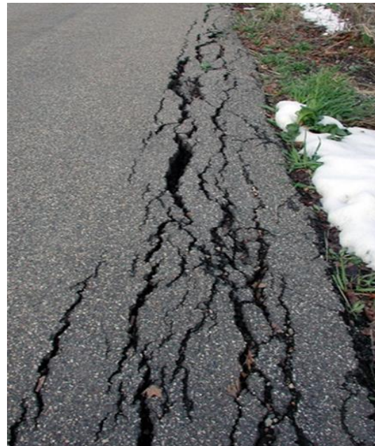
شکل ۱۳- شکستگی کشی روی آسفالت، جهت دید عکس N200°
