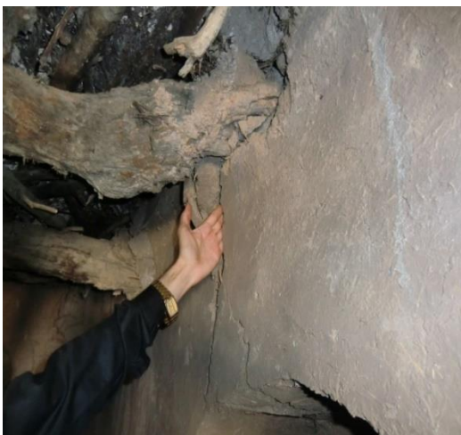
شکل ۶. تصویری از شکاف ایجادشده در دیوار منازل روستای هاوانان
